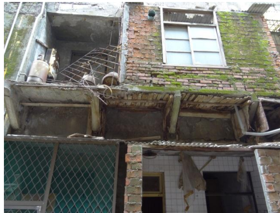
房屋外觀磁磚剝落情況嚴重
