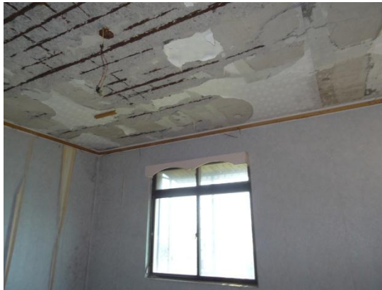
房屋現況出現鋼筋鏽蝕情形
